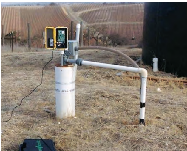
Piézomètre pour la surveillance des eaux souterraines
