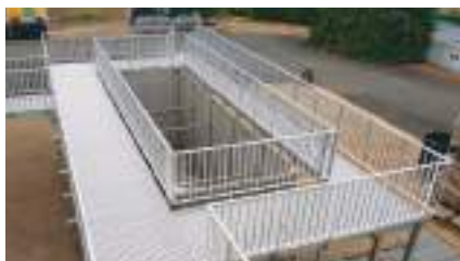
Pilote de traitement des eaux usées urbaines par boues activées
