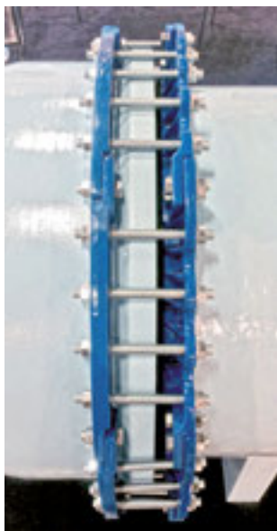
Canalisation FONTE DN 800
