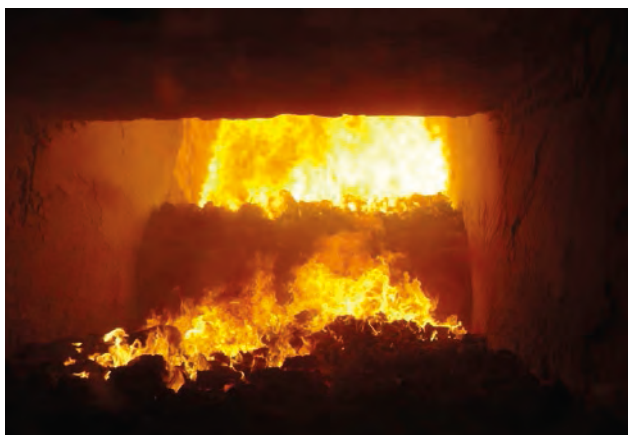
Foyer d'un four d'incinération à grilles.
