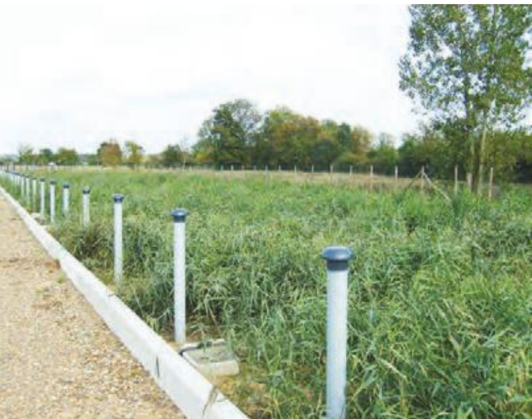
Filtres plantés de roseaux.
