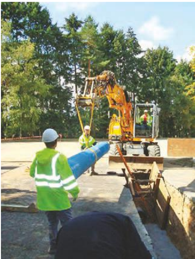
Sécurité dans la mise en œuvre des réseaux : Élingage et levage de canalisation, blindage des fouilles.
